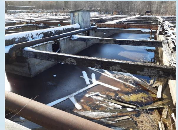
Разрушенный биореактор ЦОС
