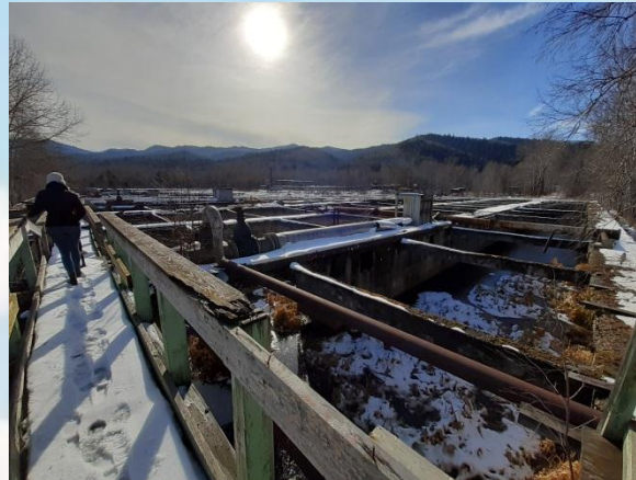
Разрушенный биореактор ЦОС
